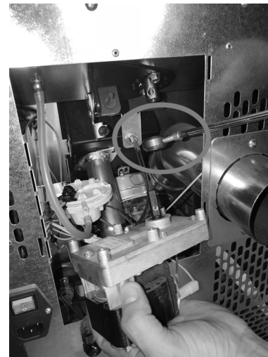
Fig. 79 - Extracción del motorreductor
