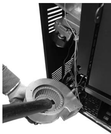
Fig. 67 - Limpieza del ventilador ambiente
