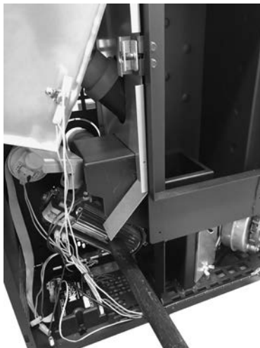
Fig. 65 - Limpieza ventilador ambiente
